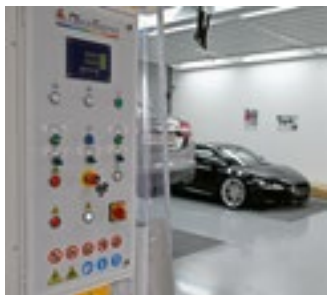
Hightech von Blowtherm wohin das Auge blickt.
