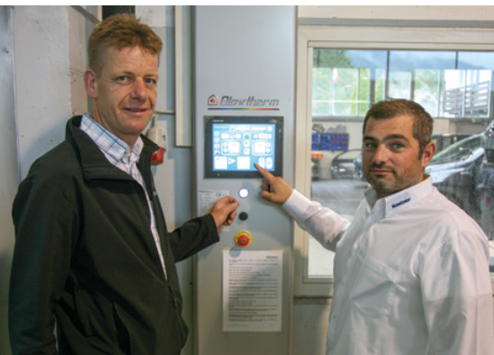
Die Bedienung der Steuerung erfolgt rasch und unkompliziert mittels Touchscreen
